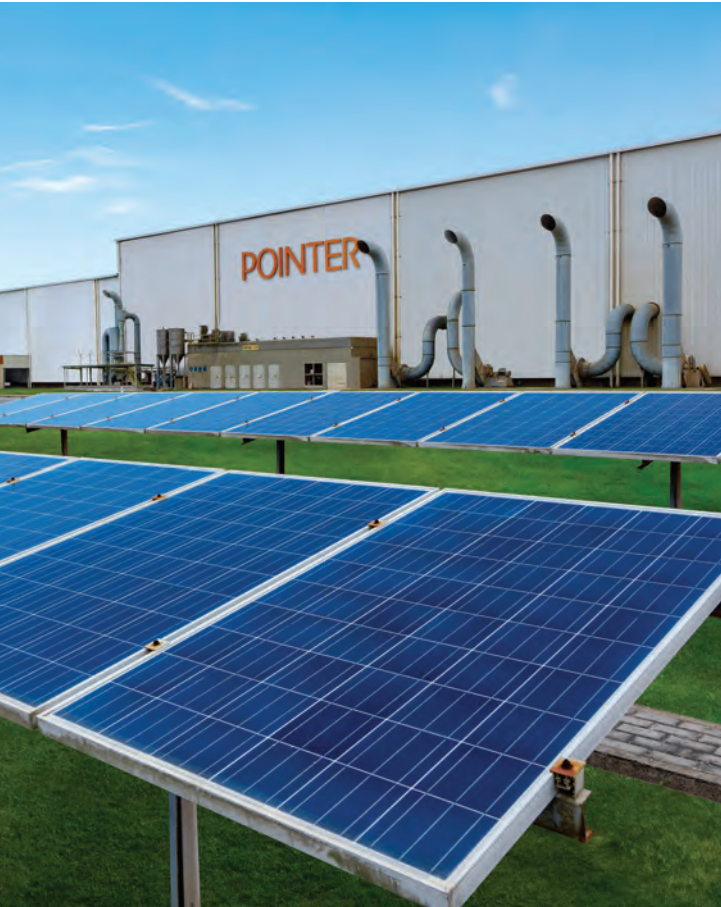
Painéis fotovoltaicos na unidade fabril de Marechal Deodoro (AL)
